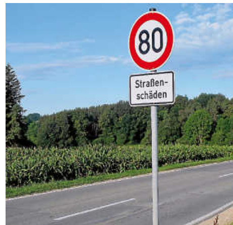
Mit mehreren Verkehrsschildern werden die Verkehrsteilnehmer auf die Straßenschäden der L 218 und L 196 verbunden mit einer Geschwindigkeitsbegrenzung hingewiesen. Fotos: Wilfried Koch
